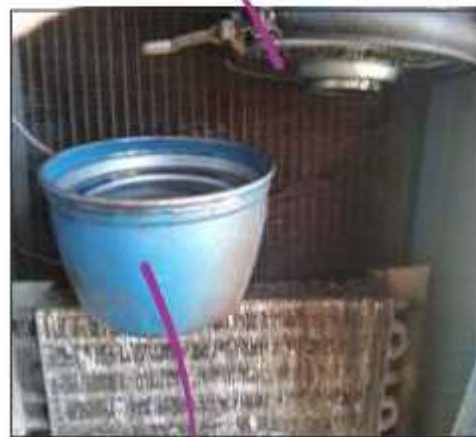
Deposito de aceite
